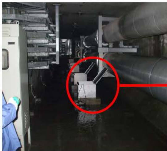
3月11日時点の状態 (潮位計BOXの上蓋が海水に押し上げられ開放)
